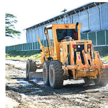
Las calles de tierra han estado terriblemente dañadas por las lluvias.
