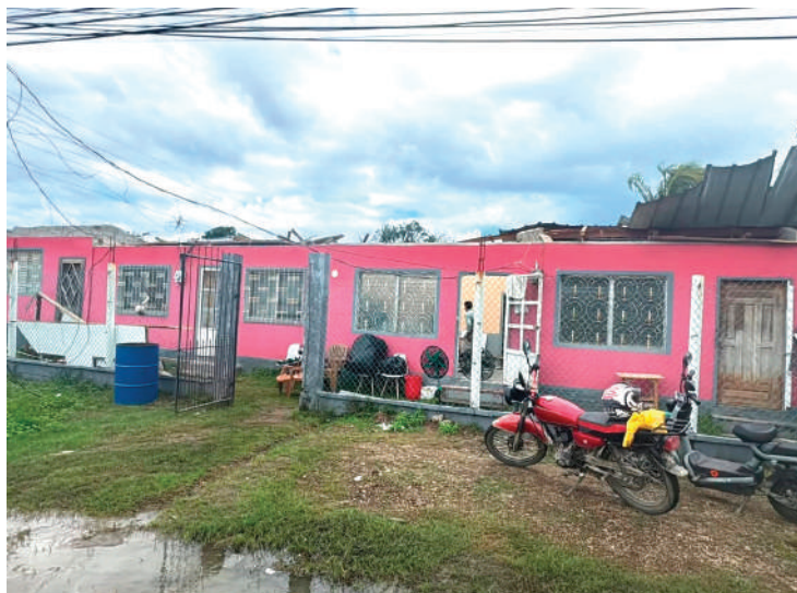
Techos arrancados y estructuras dañadas en una vivienda tras el paso de vientos asociados al fenómeno meteorológico.
