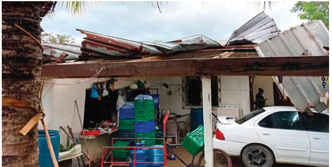
Vivienda afectada por la voladura de su techo en uno de los barrios impactados por la tromba marina.
