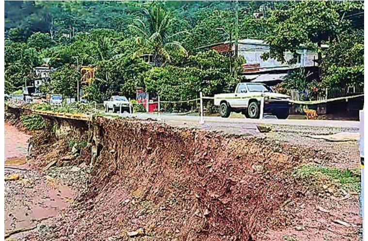
El río sigue socavando la carretera internacional, a la altura del barrio El Estribo, en Santa Rita, Copán.
