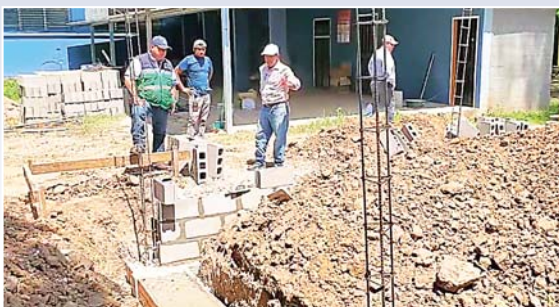
El alcalde de Olanchito, Juan Carlos Molina, supervisando la construcción de la clínica odontológica.
