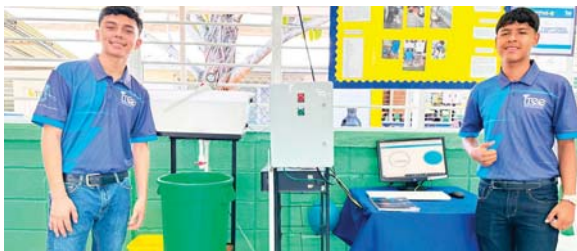
Control y monitoreo de sistema de llenado, realizado por estudiantes de Electromecánica. Con este el usuario sabe en que capacidad está un tanque de llenarse o si está vacío.
